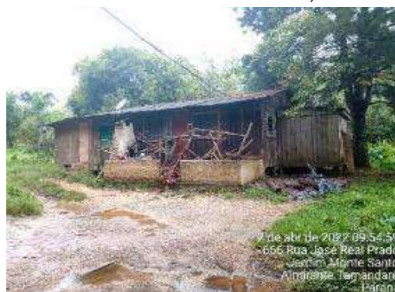
Foto 10 - Propriedades sem edificações ou abandonadas.
