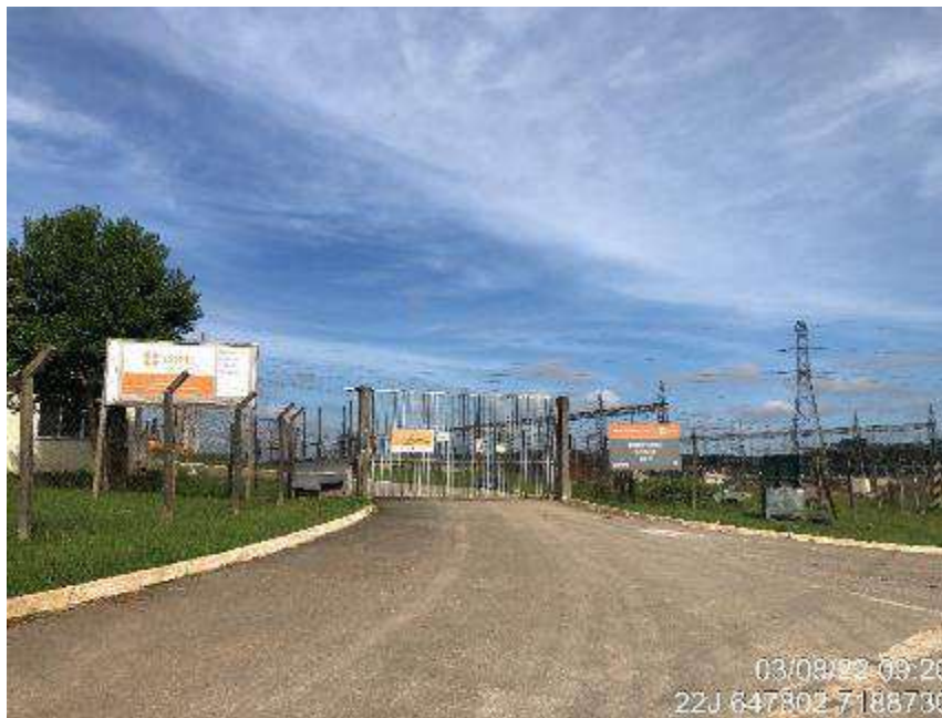
Foto 38 – Subestação Bateias 535 kV (COPEL).
